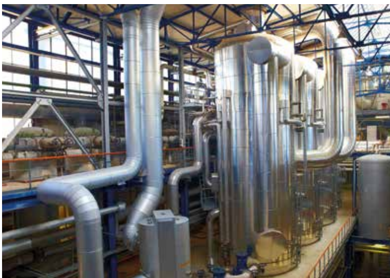
Teil der Verdampfstation
