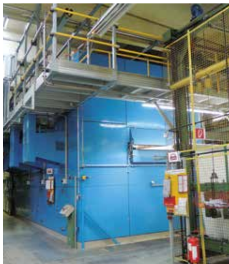
Trommeltrockner nach der Umrüstung auf Gas
